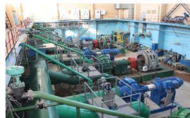
Очистные сооружения и канализационно-насосные станции объектов Водоканала
